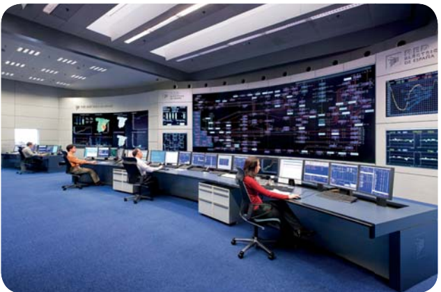
Centro de control eléctrico (CECOEL) de Red Eléctrica de España.
